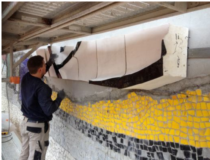
Restauration de la façade Repose de la première ligne des modules sur rail
